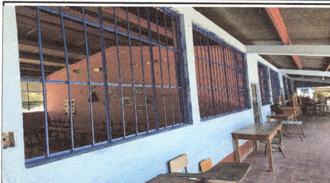
Pintura exterior del edificio en mal estado
